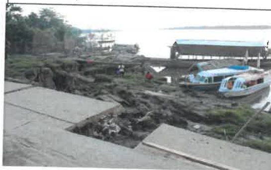
Figura 3.1-5: Riberas de la localidad de Maypuc, se observa avance de erosión en las riberas con daño a los bloques de concreto de las veredas de la localidad
