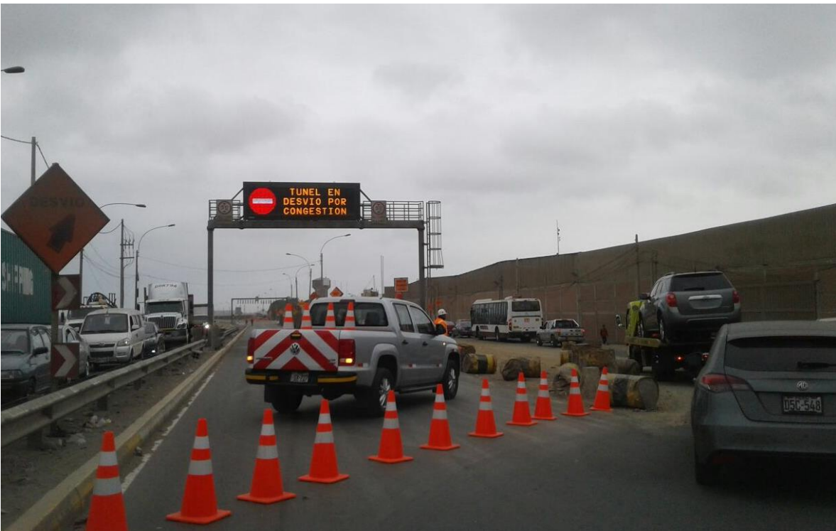
Ilustración 4 Desvío por cierre de túnel Gambetta
