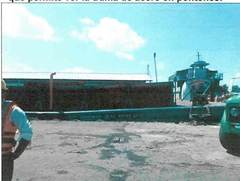
Inspección de las obras de río, se aprecia un deterioro en el asfalto que permite ver la trama de acero en pontones.
