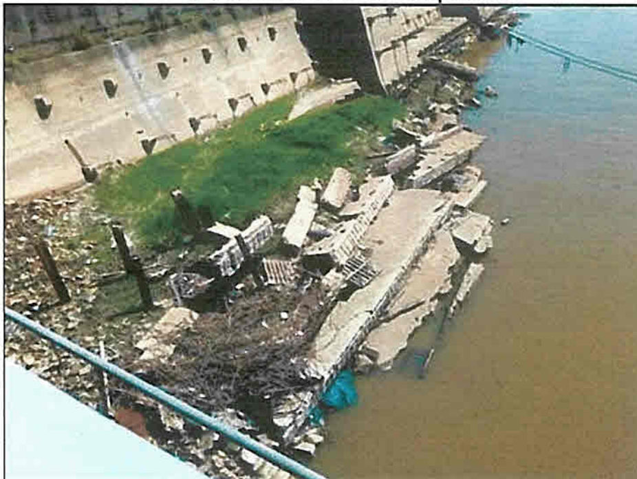
Inspección de las obras de río se aprecia que las estructuras de la ribera han colapsado
