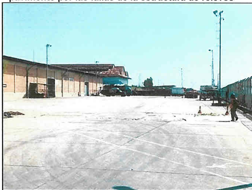
Vista del patio de maniobras con daños al pavimento por las fallas de la estructura de relevos
