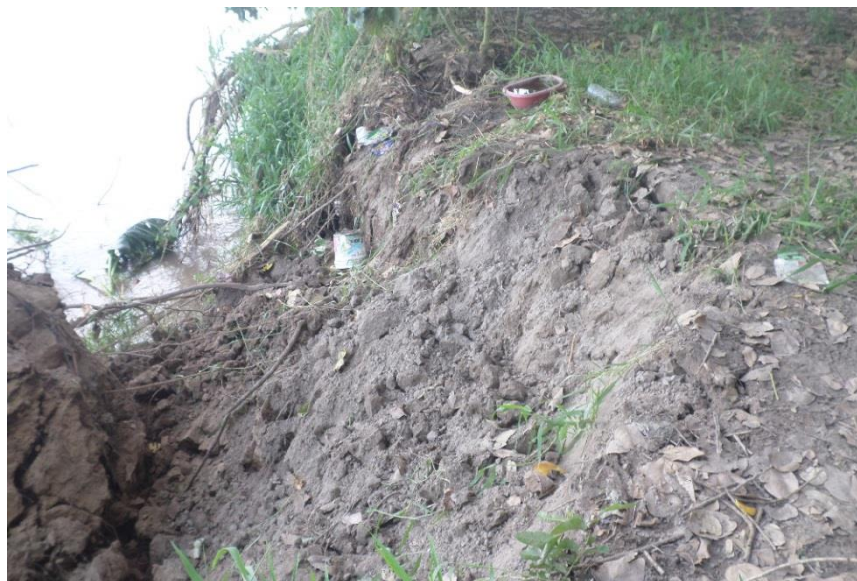
Figura 3.1-24: Zona de inestabilidad en margen de terraza, a unos metros de la segunda propuesta de eje portuario.
