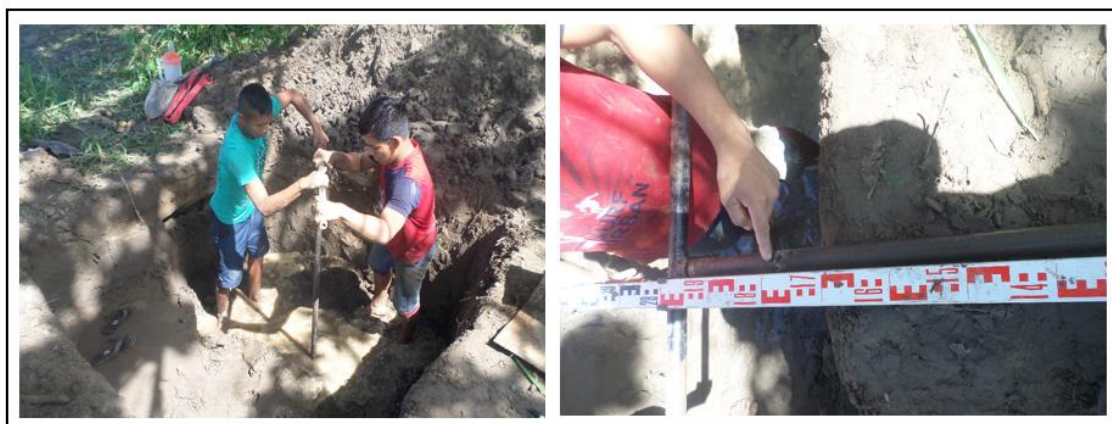
Figura 4.1-65: Excavación de la calicata 01, con ayuda de una barrena manual para llegar hasta los 2.70m de profundidad.
