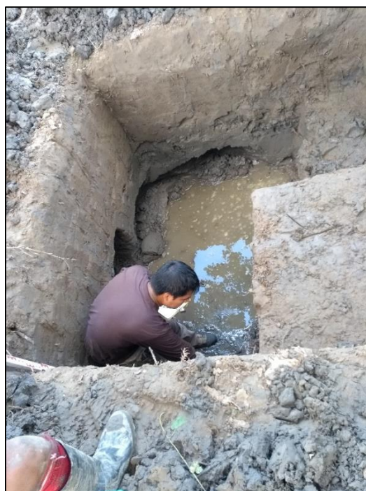
Figura 3.2-35: Desmoronamiento del bloque de suelo en la calicata C-3-SAR Fuente: Elaboración propia. (Mayo 2018).
