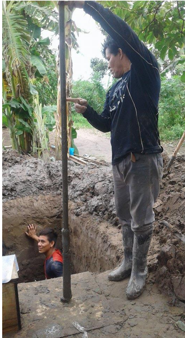
Figura 4.1-67: Excavación de la calicata 03, con ayuda de una barrena manual para llegar hasta los 2.50m de profundidad.
