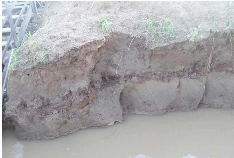
Figura 3.1-22: Geología de la localidad de Santa rosa, talud de ribera.
